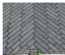
敷地境界でタイルの並びが変わっていました。
